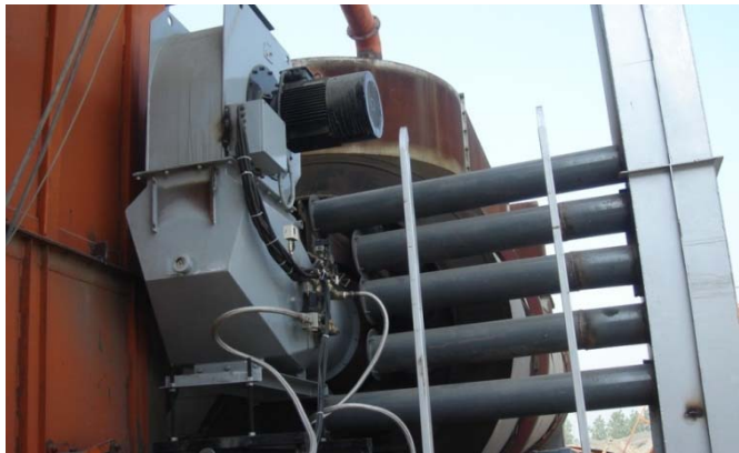
再生尾气燃烧装置
