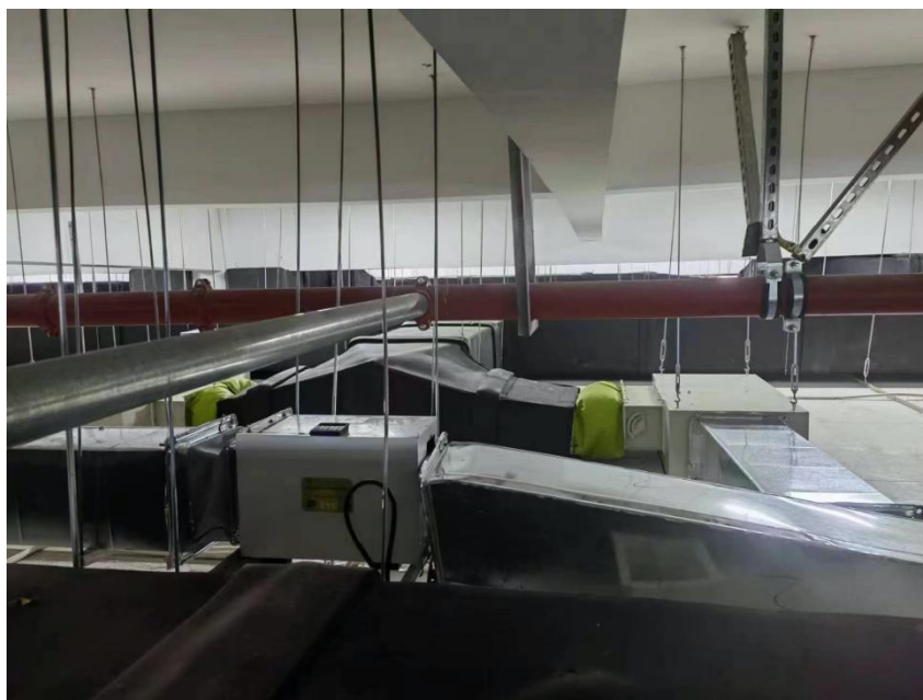
项目废气经过活性炭吸附装置后通过洁净系统回风至车间内循环的现状照片
