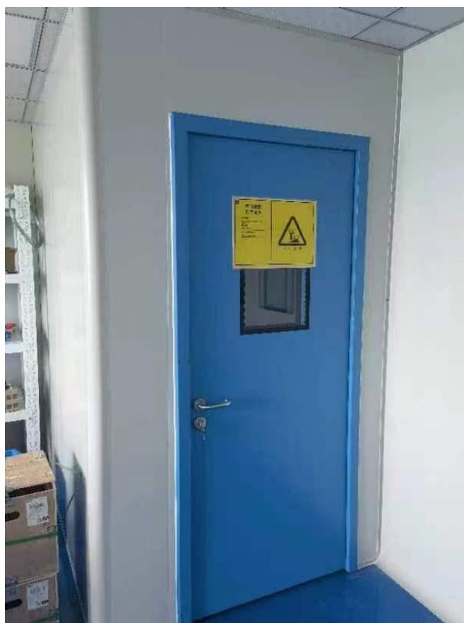
项目危废仓库照片
