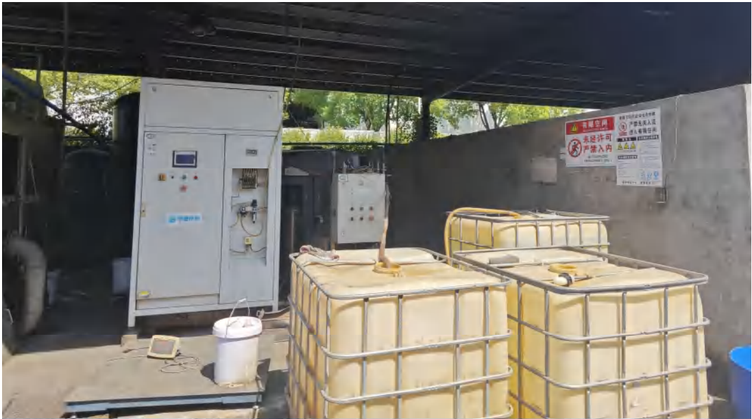
图 2.4-4 企业现有项目低温蒸发箱系统现状照片
