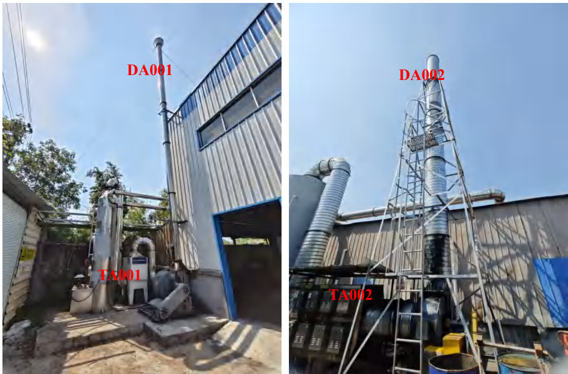
图 2.4-1 企业现有项目淬火油烟净化装置现状照片
