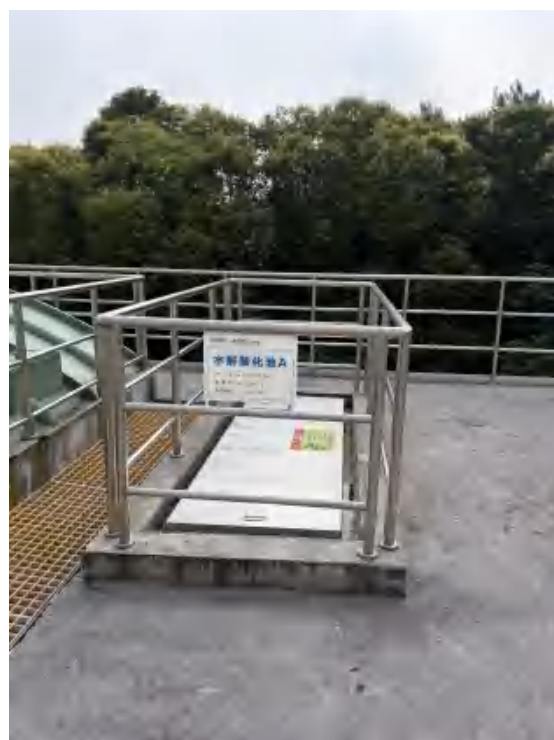
污水处理站（水解酸化池）
