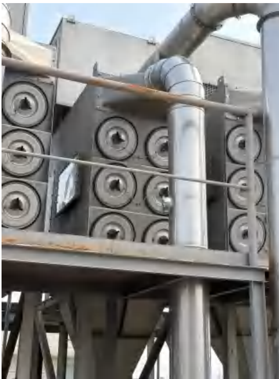
1#称量粉尘处理设施（滤筒除尘）
