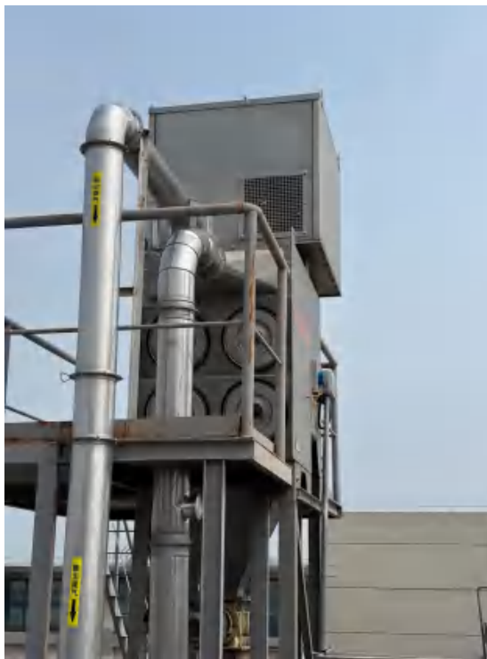
2#称量粉尘处理设施（滤筒除尘）
