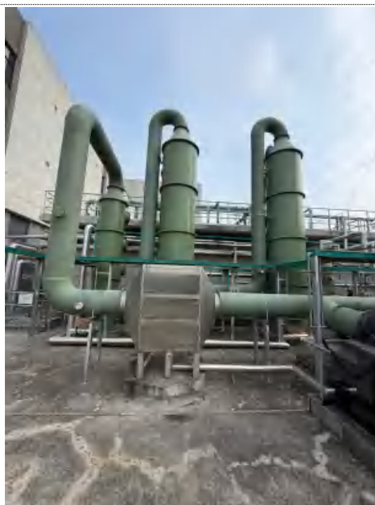
污水处理站废气处理设施（二级碱喷淋+除雾器+活性炭吸附）
