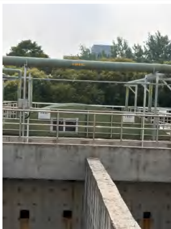
污水处理站（好氧池）
