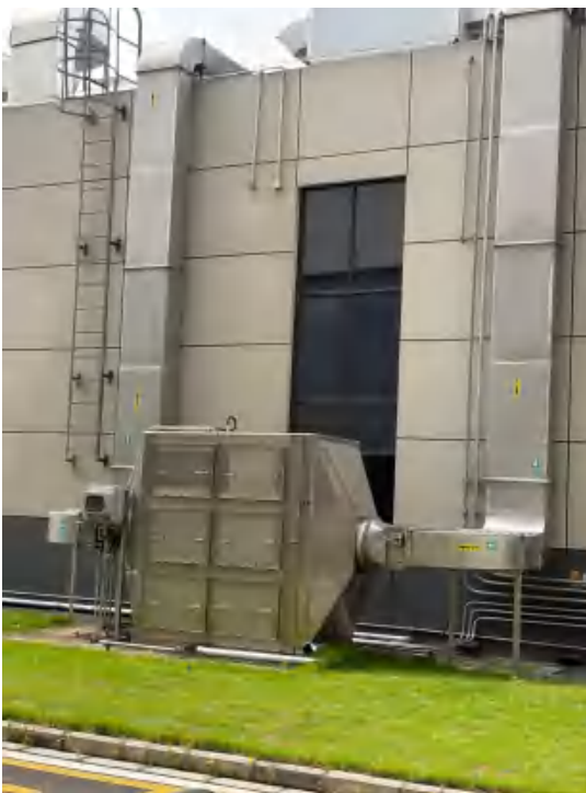
危废间废气处理设施（活性炭吸附）
