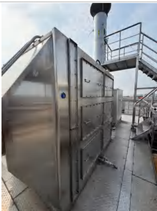
研发试验废气处理设施（活性炭吸附）
