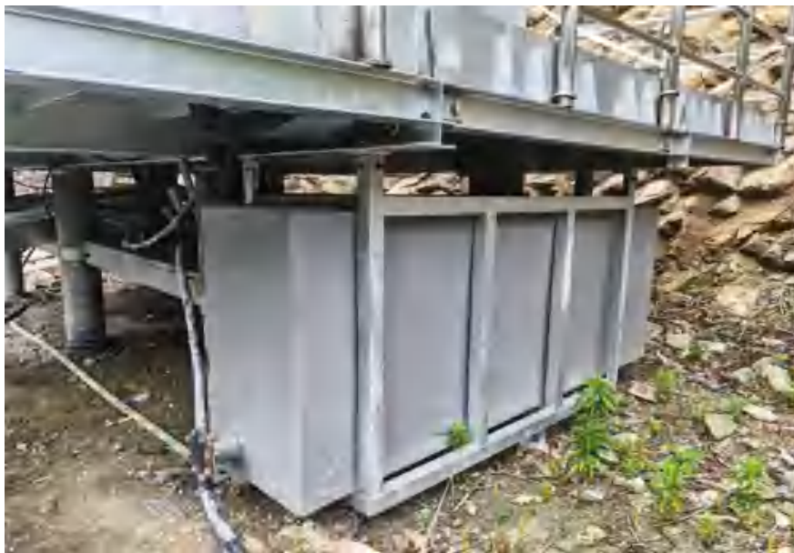
光伏区箱变配套事故油池图
