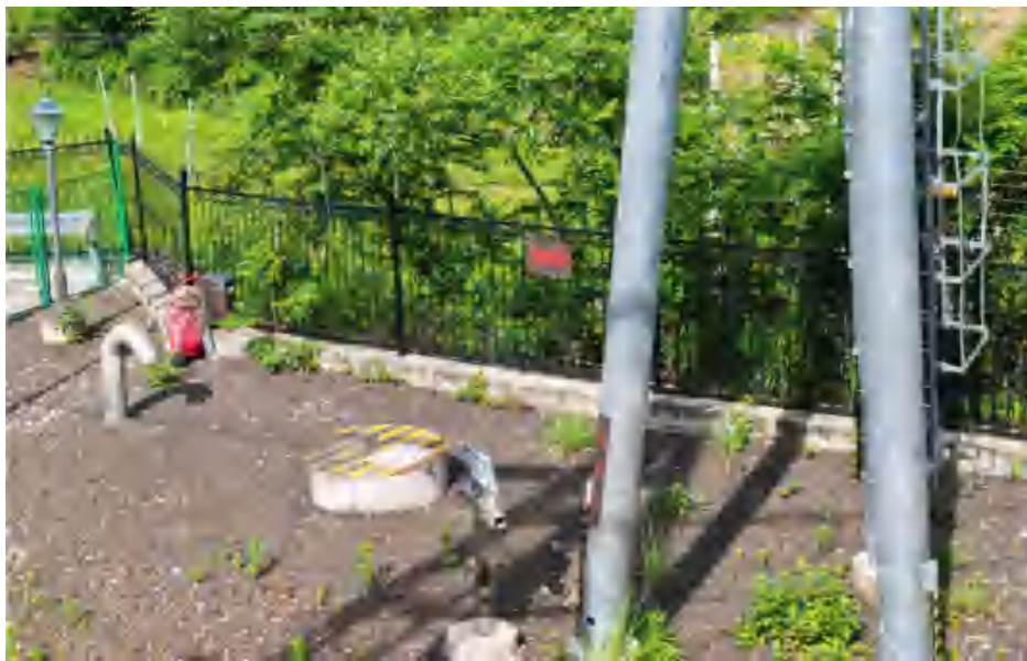
升压站配套事故油池图
