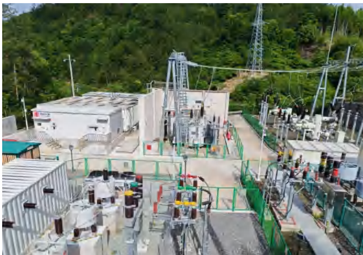
110KV 升压站照片
