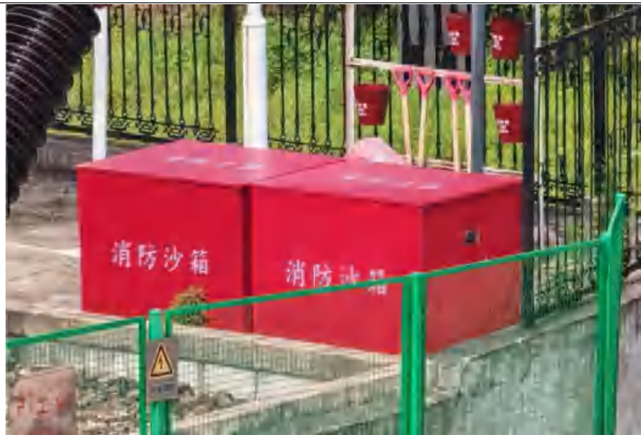
升压站配套消防沙箱图
