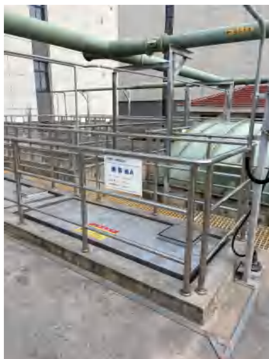
污水处理站（兼氧池）
