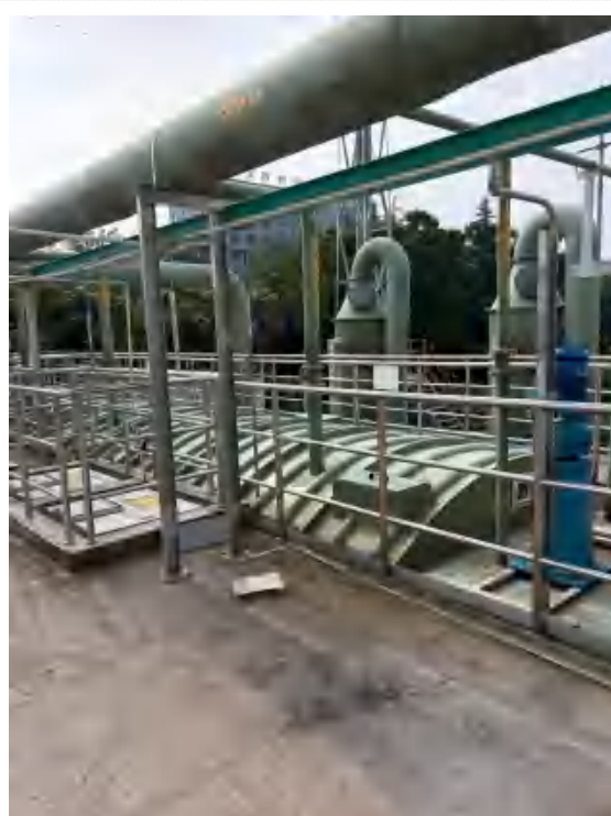
污水处理站（沉淀池）
