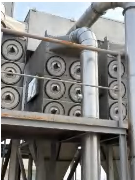
1#称量粉尘处理设施 (滤筒除尘)
