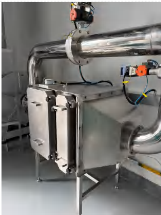
制粒/干燥/整粒机组粉尘处理设施 (高中效二级过滤除尘器)
