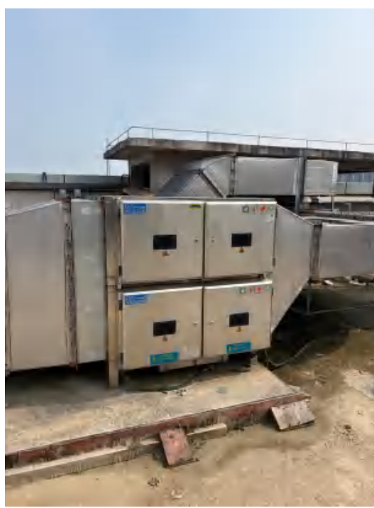
食堂油烟废气处理设施（油烟净化器）
