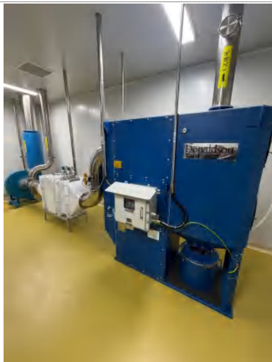
包衣机粉尘处理设施 (初中高效过滤器+滤筒除尘)
