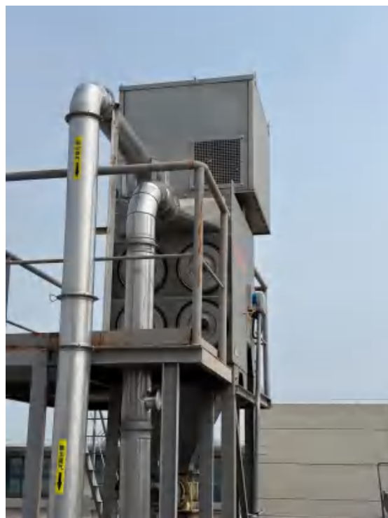
2#称量粉尘处理设施 (滤筒除尘)
